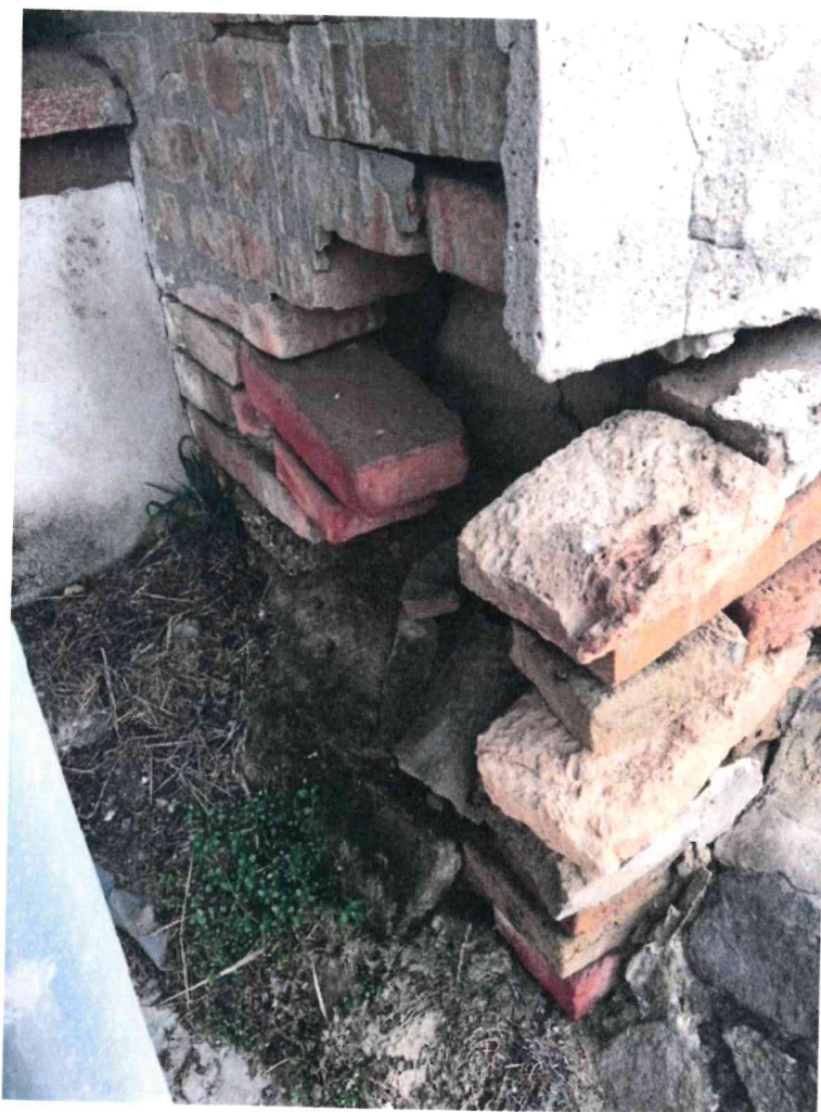
A falszerkezet tönkremenetele az utcai homlokzaton Ny-i sarok
