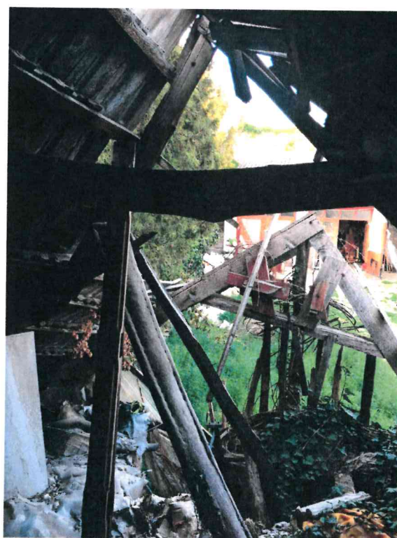
Az udvari oromfal tönkremenetele
