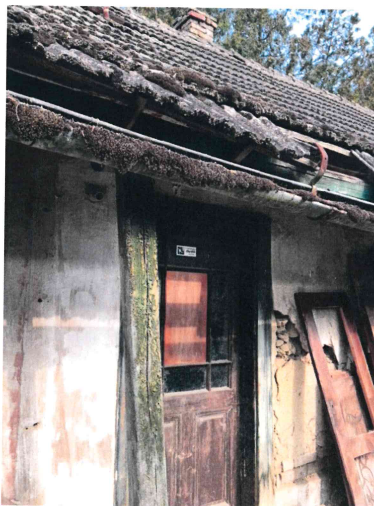
Bejárati ajtó, tönkrement eresz
