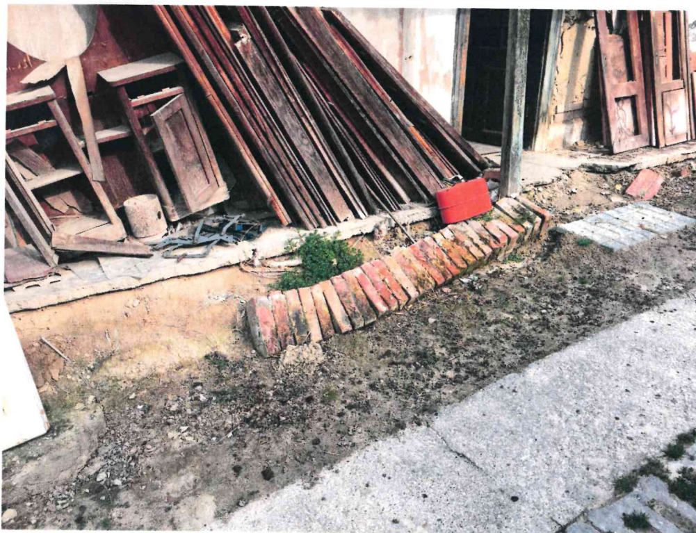
A tornác járdaszegélyének süllyedése
