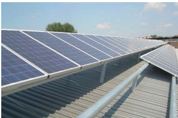
2. ábra A P épület tetejére felszerelt napelem rendszer
