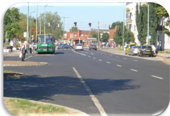
A buszpályaudvar melletti forgalmas úttest legterheltebb szakasza részben pályázati, részben saját forrásból felújításra került. Az alatta található közművek cseréje is megtörtént.
