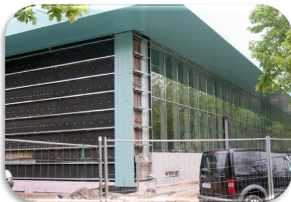
Zajlik a helyi sportuszoda energetikai felújítása, mely a szigetelés és a nyílászárók cseréjét jelenti, valamint korszerűbb légtechnikai gépeket kap a létesítmény
